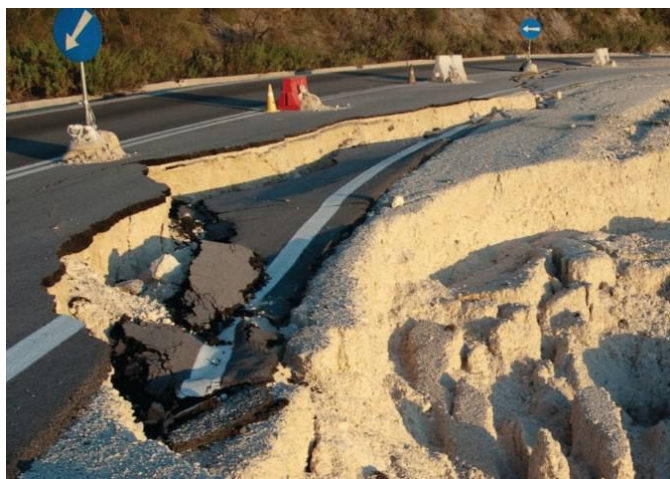
Érosion d'une route. Source : www.tensarcorp.com
