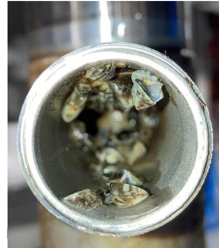
Conduite d'eau potable municipale Photo: Ville de Sherbrooke
